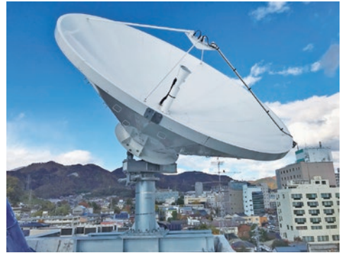
4.5 mφ衛星通信地球局用アンテナ (株長野放送 本社)
